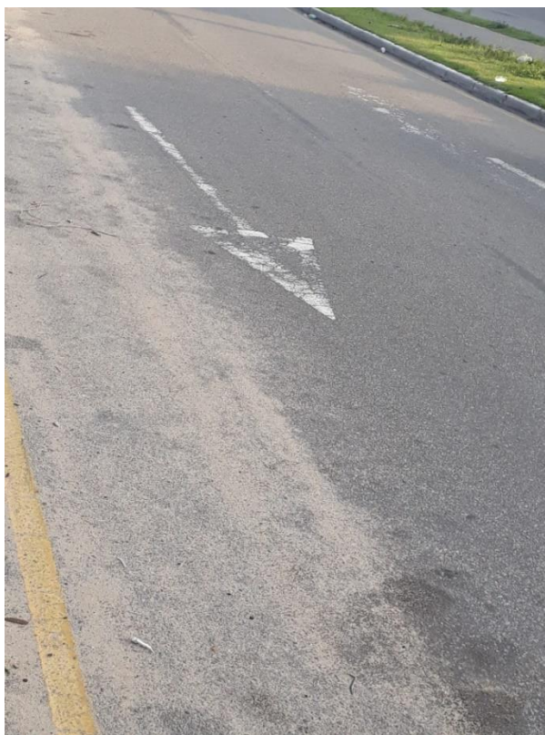
Figura 93 - Sinalização precária Av. Gil de Góes
