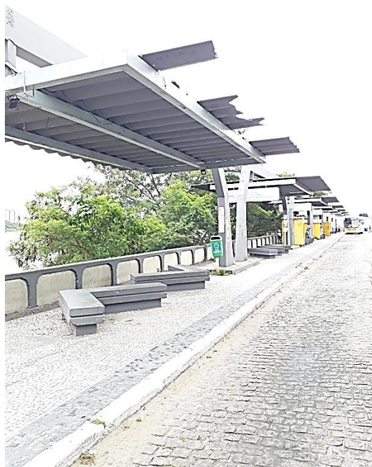
Figura 128 - Precariedade terminal Carlos Prestes
