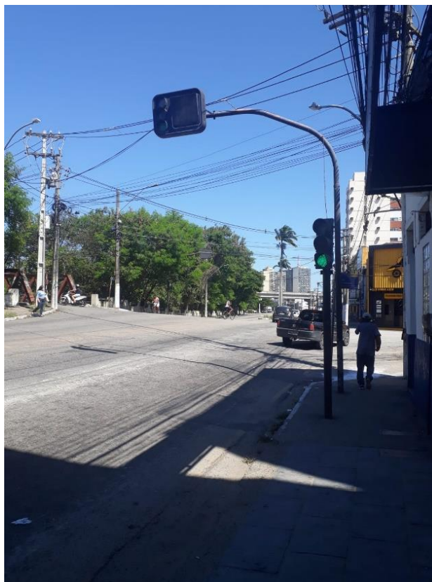
Figura 97 - Semáforo com contador led queimado - Local Av. XV. de novembro - frente ao Palace Hotel
