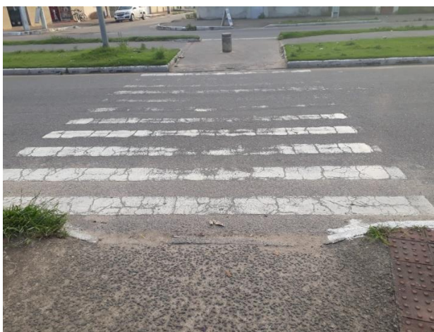
Figura 92 - Sinalização precária Av. José C. P. Pinto
