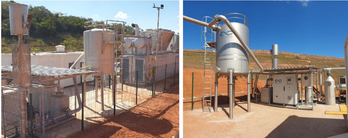
Figura 11 – Usina de Biogás no aterro sanitário Conselheiro Josino
