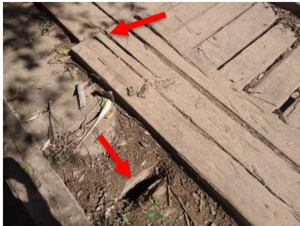
Figura 17 – Desprendimento da madeira e vão no tabuleiro
