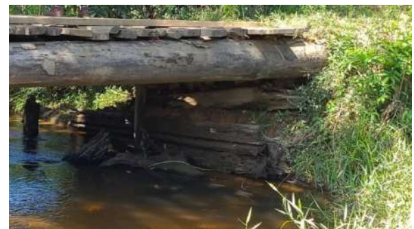
Figura 20 – Apoio com madeiras em estado avançado de deterioração, dispostas sem padrão bem definido
