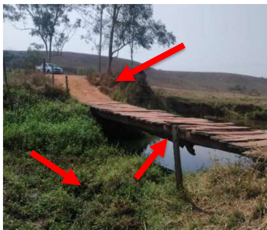
Figura 3 – Desnível na pista, instabilidade do tabuleiro. Tabuleiro instalado sem padrão bem definido. Vegetação intensa no leito do rio.
