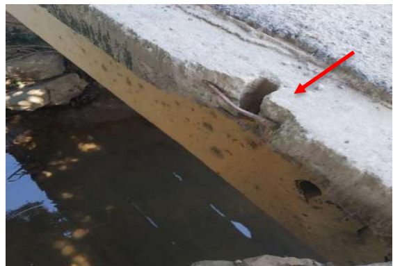
Figura 108 – Exposição das armaduras.
