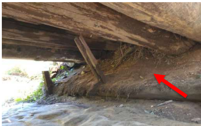
Figura 44 – Indícios de escorregamento do talude.
