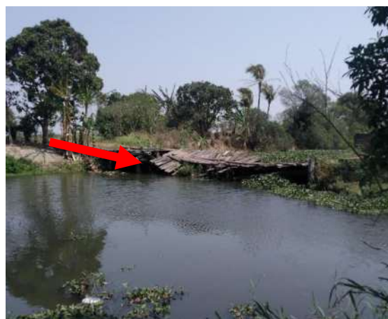
Figura 44 – Foto 14 – Afundamento do tabuleiro devido ao tombamento do apoio.
