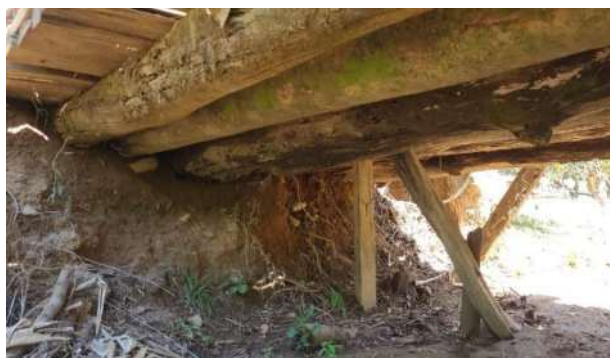
Figura 23 – Vigas longitudianis em estado de deterioração, presença de fissuração
