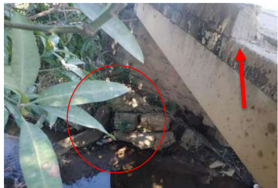
Figura 110 – Pedras no encontro, e guarda rodas quebrado.
