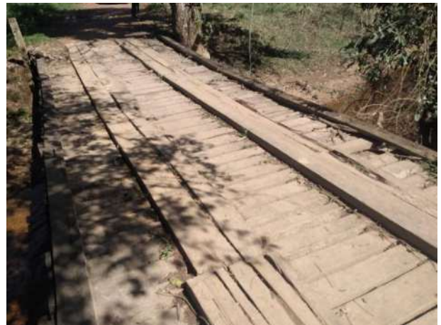
Figura 18 – Peças de madeira com fissuração
