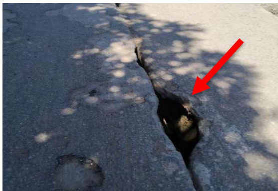
Figura 107 – Buracos no tabuleiro.
