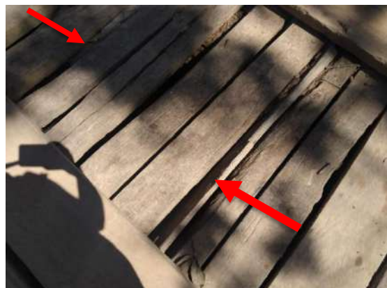
Figura 45 – Instabilidade das peças de madeira que compõem a estrutura. Peças de madeira deterioradas e danificadas
