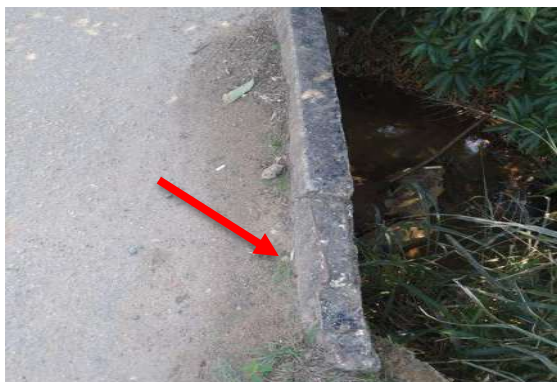
Figura 111 – Guarda rodas quebrado.
