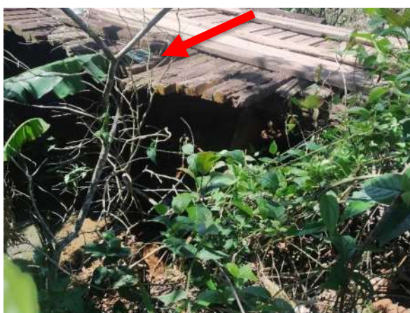
Figura 140 – Instabilidade do tabuleiro e vegetação intensa no entorno da ponte.
