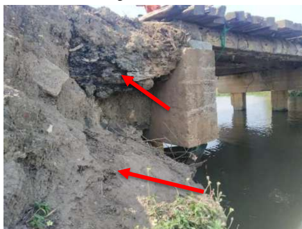
Figura 6 - Encontro com madeiramento deteriorado. Escorregamento do talude.
