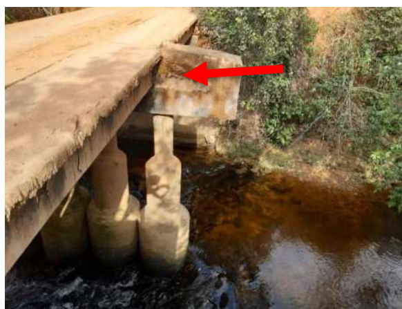
Figura 64 – Elementos sem manutenção e ponte sem proteção.
