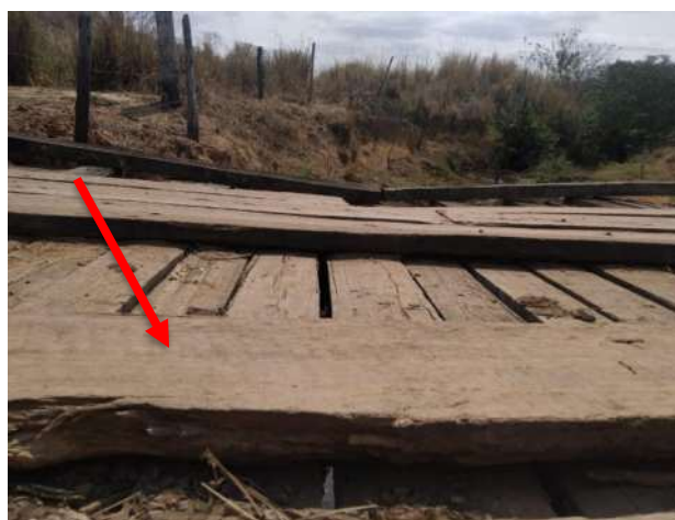
Figura 84 – Peças do tabuleiro soltas e quebradas.
