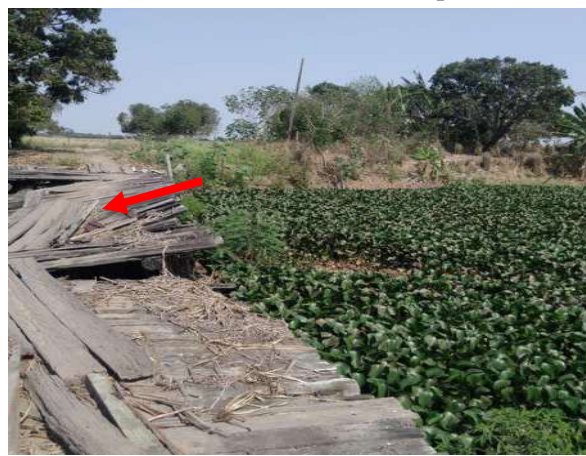
Figura 46 – Foto 3 – Tabuleiro em descontinuidade.
