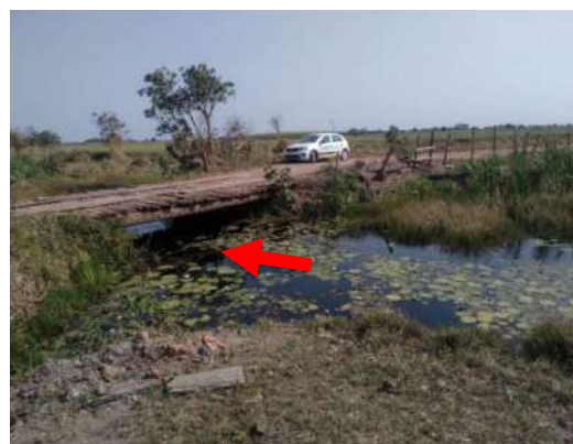
Figura 67 – Inexistência de apoio.
