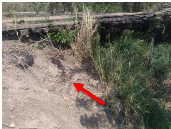
Figura 85 – Indícios de escorregamento do talude.
