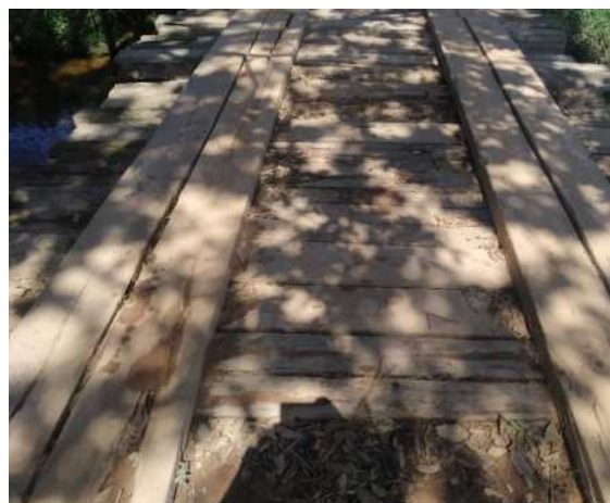
Figura 47 – Peças de madeira que compõem a estrutura danificadas e instaladas sem padrão definido.
