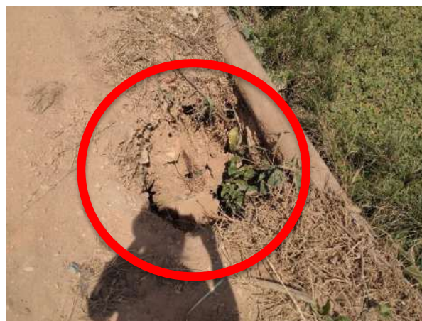
Figura 23 – Afundamento do tabuleiro que apresenta processo de erosão do material que o compõe.
