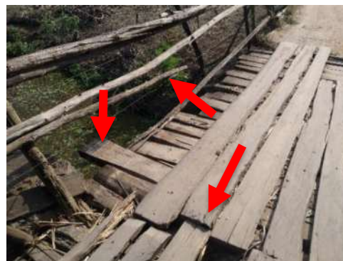
Figura 103 – Situação atual da ponte provisória: Peças de madeira danificadas.
