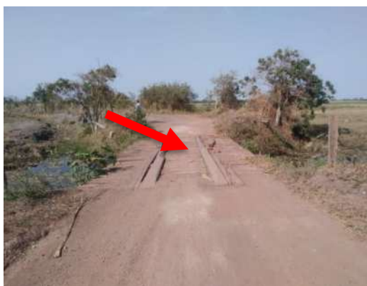
Figura 66 – Desprendimento da madeira.
