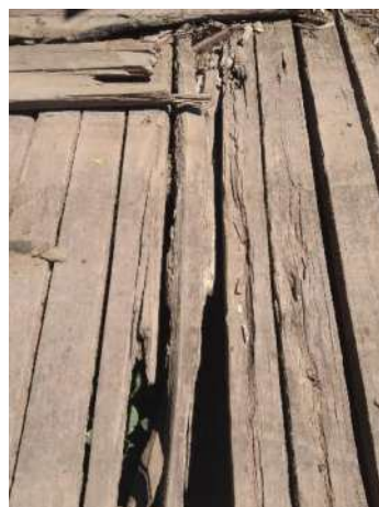
Figura 137 – Tabuleiro em madeira com peças danificadas.
