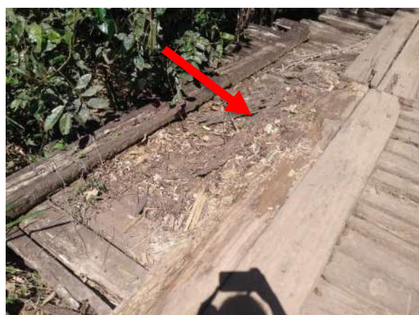
Figura 141 – Tabuleiro com fissuras, desgaste, deteriorado.
