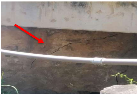
Figura 109 – Fissuração nas longarinas.
