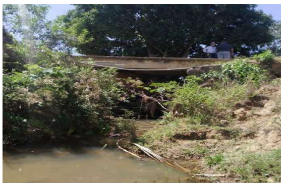
Figura 113 – Intensa vegetação nos taludes.
