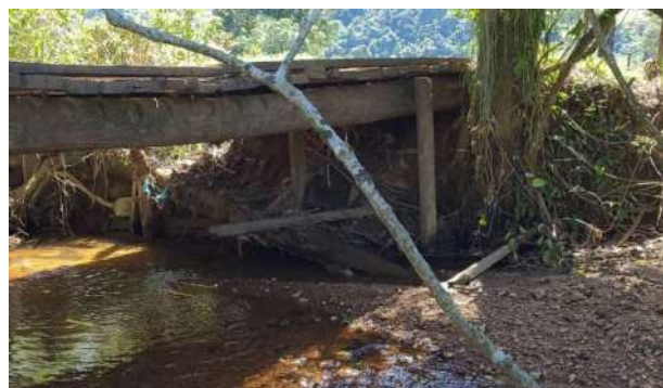
Figura 24 – Apoio com madeiras em estado avançado de deterioração, dispostas sem padrão bem definido, vegetação intensa nos taludes
