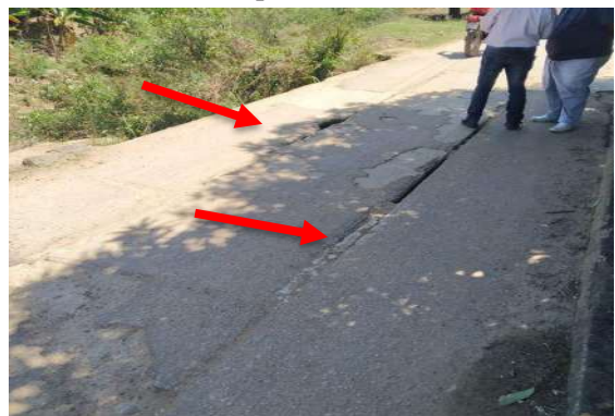
Figura 112 – Tabuleiro com buracos, fissuras, desgaste e deteriorado.
