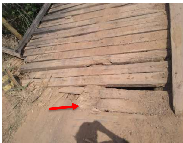
Figura 85 –Elementos da ponte apoiados no solo.
