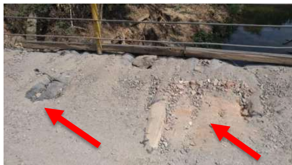
Figura 21 – Afundamento do tabuleiro que apresenta processo de erosão do material que o compõe.
