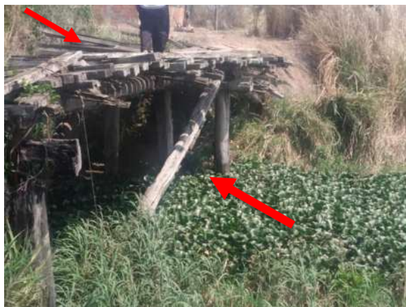
Figura 86 – Instabilidade das peças de madeira que compõem a estrutura. Vegetação intensa no canal e arredores. Peças de madeira deterioradas e com ação intensa de insetos.
