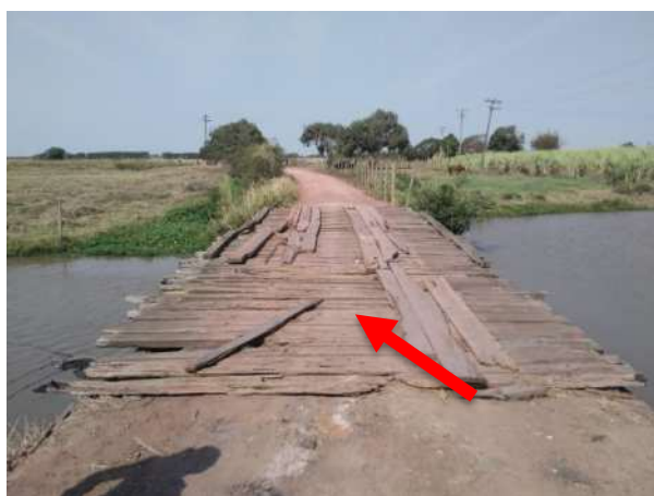
Figura 3 – Peças de madeira soltas, quebradas/fissuradas/deterioradas. Instaladas sem padrão bem definido.
