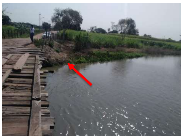
Figura 5 - Escorregamento do talude e peças de madeira soltas/descontínuas/quebradas no tabuleiro.
