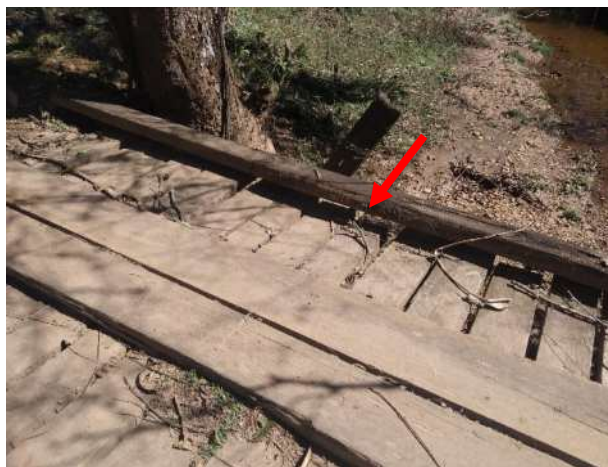
Figura 19 – Peças de madeira com desprendimento
