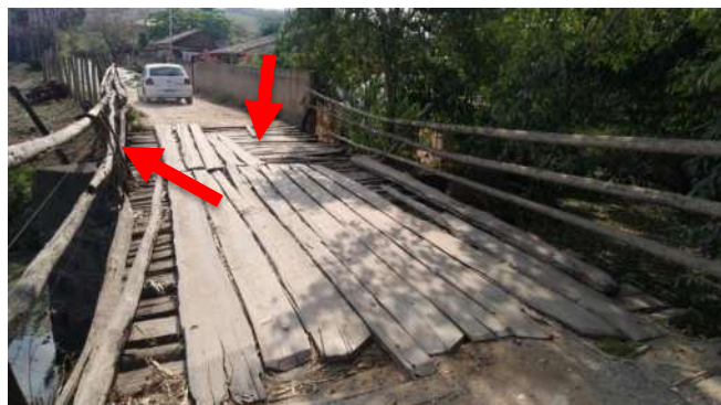
Figura 102 – Situação atual da ponte provisória: tabuleiro em peças de madeira instaladas sem padrão bem definido, quebradas. Guarda-corpo em madeira com sinais de instabilidade. Ausência de sinalização.
