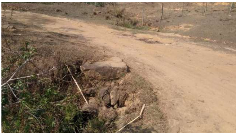
Figura 46 – Indícios de processo erosivo e escorregamento no aterro da rota alternativa utilizada em caráter provisório
