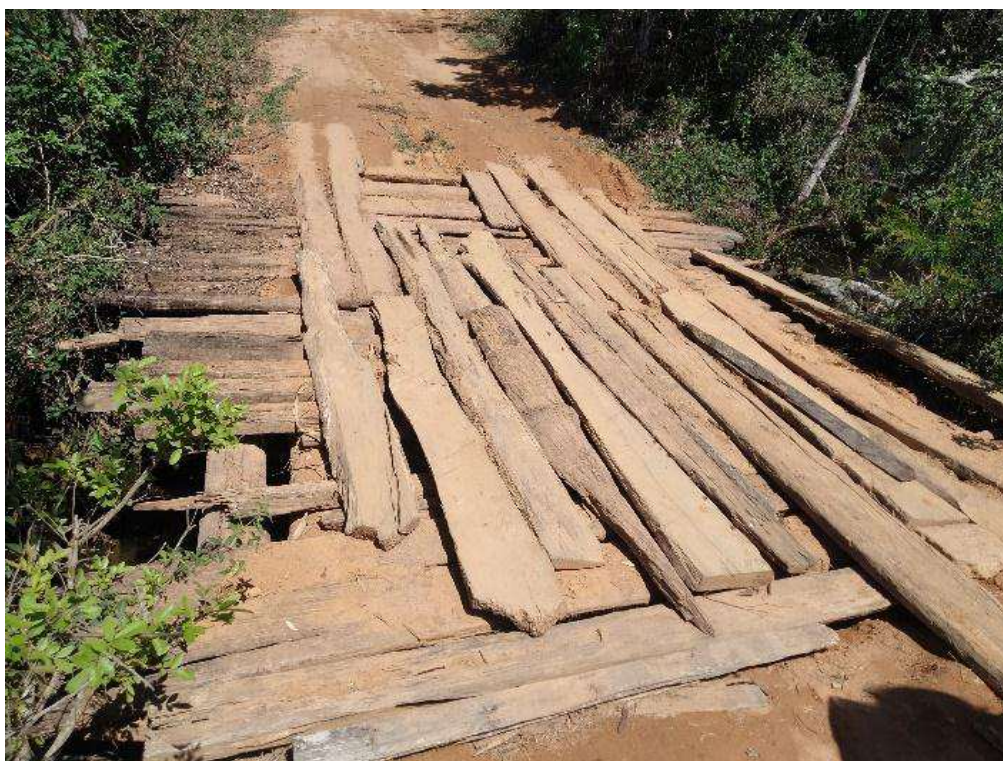
Figura 3 - Tabuleiro em situação precária: peças danificadas, dispostas sem padrão definido, soltas, com presença de vãos, com sinais de instabilidade.
