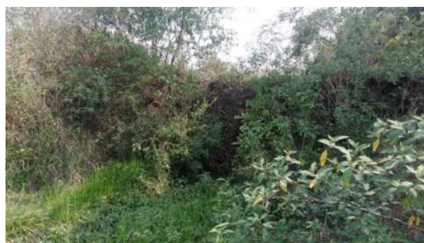
Figura 41 – Vegetação intensa sobre a estrutura.
