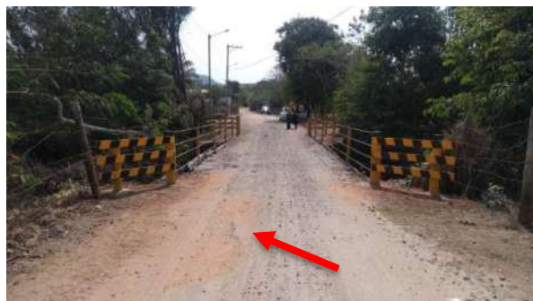
Figura 20 – Sinais de desgaste do revestimento do tabuleiro.
