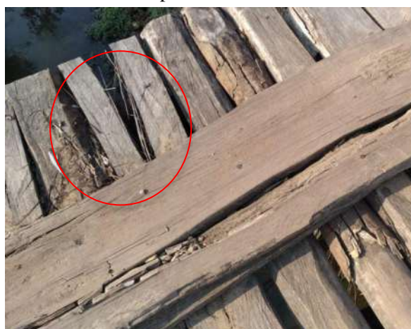
Figura 62 – Peças de madeira rachadas e com desgaste.
