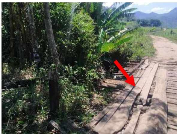
Figura 138 – Tabuleiro danificado e vegetação intensa no entorno da ponte.
