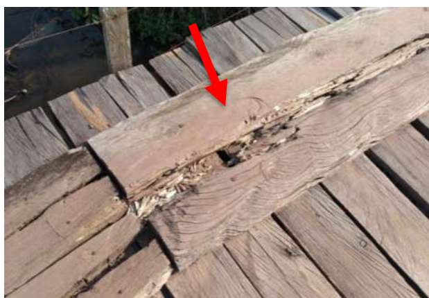
Figura 59 - Tabuleiro com fissuras e rachaduras.
