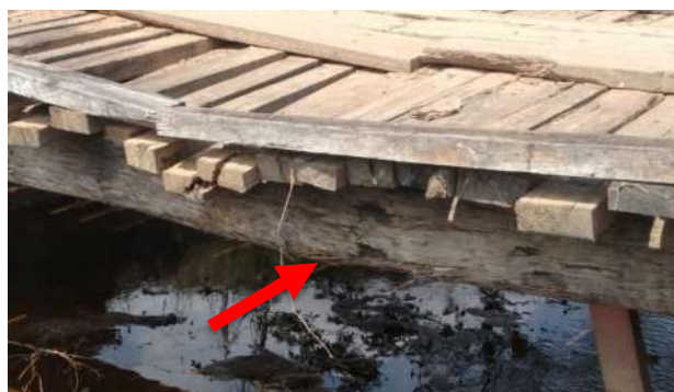
Figura 82 - Longarina com fissuras e fletindo.
