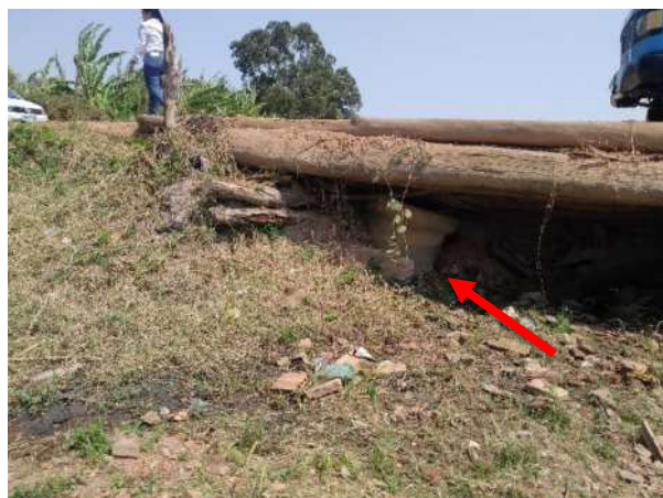
Figura 25 - Encontro com madeiramento de caráter provisório, desordenado e em deterioração.
