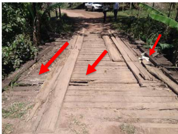
Figura 136 – Buracos no tabuleiro.
