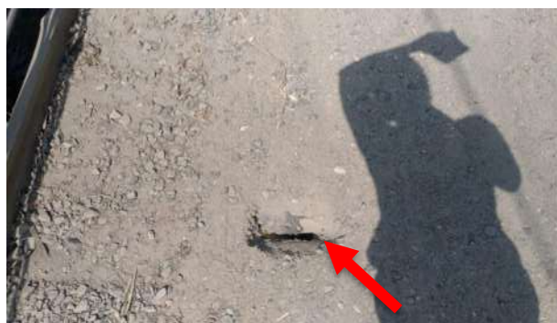
Figura 22 – Buraco no tabuleiro devido processo de erosão do material que o compõe.
