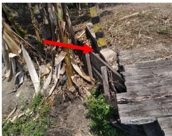
Figura 3 – Foto 4 – Encontro em concreto apresenta erosão.
