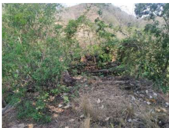
Figura 40 – Tabuleiro gravemente danificado, com peças de madeira quebradas, deterioradas. Vegetação intensa sobre a estrutura.
