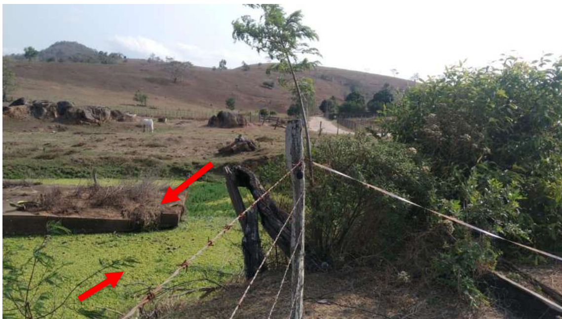
Figura 101 – Vegetação intensa no leito do rio e presença robustas de peças de concreto.
