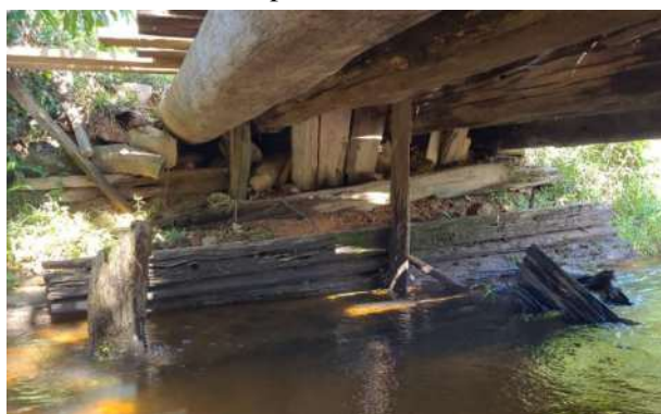
Figura 21 – Apoio com madeiras em estado avançado de deterioração, dispostas sem padrão bem definido
