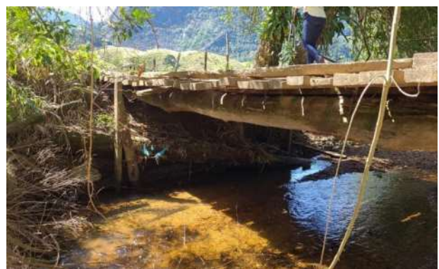
Figura 22 – Apoio com madeiras em estado avançado de deterioração, dispostas sem padrão bem definido, vegetação intensa nos taludes
