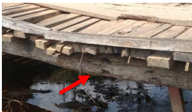
Figura 82 - Longarina com fissuras e fletindo.
