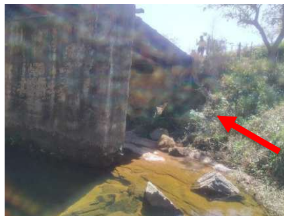
Figura 83 – Vegetação adentrando o talude.
