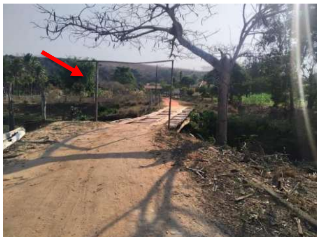
Figura 61 – Inexistência de elementos de sinalização e elementos para segurança.
