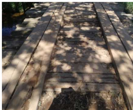
Figura 47 – Peças de madeira que compõem a estrutura danificadas e instaladas sem padrão definido.
