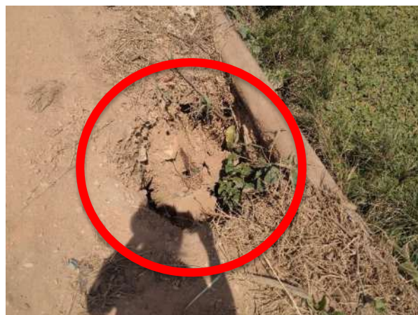
Figura 23 – Afundamento do tabuleiro que apresenta processo de erosão do material que o compõe.
