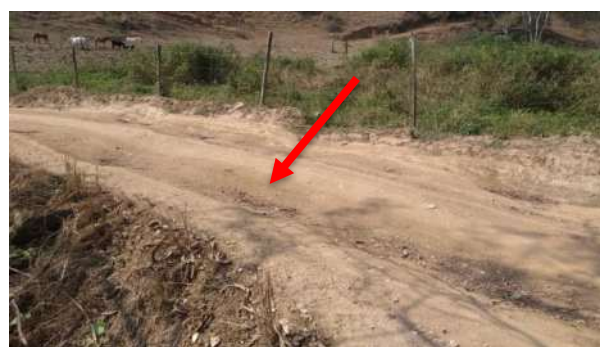
Figura 45 – Afundamentos sistemáticos na rota alternativa utilizada em caráter provisório
