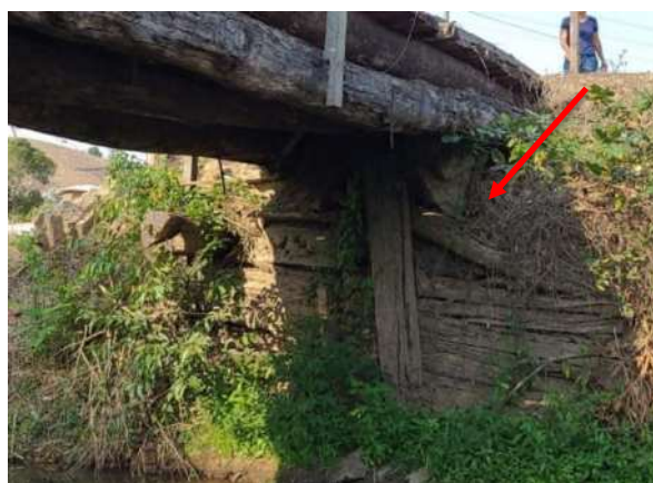
Figura 60 – Contenção de talude com madeiras em péssimo estado.
