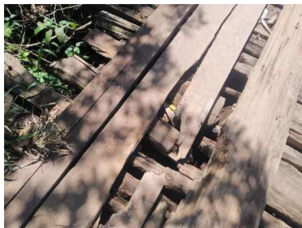
Figura 139 – Tabuleiro com peça danificada.
