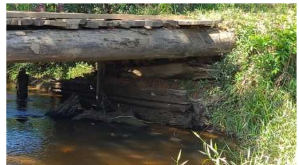
Figura 20 – Apoio com madeiras em estado avançado de deterioração, dispostas sem padrão bem definido
