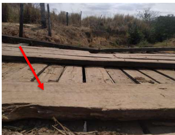
Figura 84 – Peças do tabuleiro soltas e quebradas.
