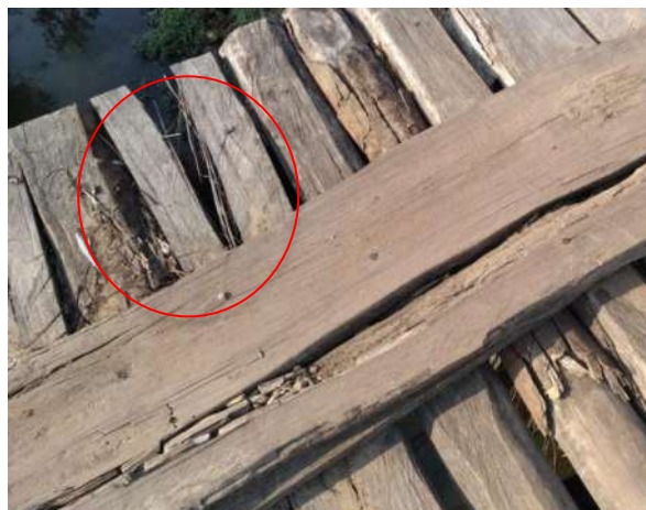
Figura 62 – Peças de madeira rachadas e com desgaste.
