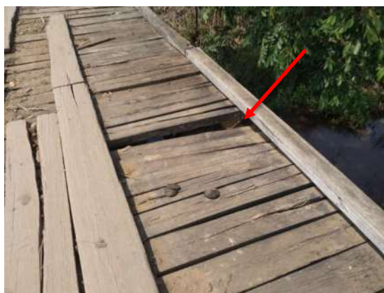
Figura 83 – Tabuleiro co peças quebradas.
