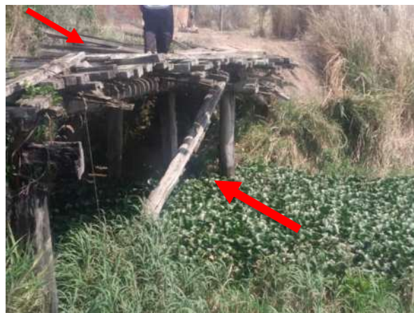
Figura 86 – Instabilidade das peças de madeira que compõem a estrutura. Vegetação intensa no canal e arredores. Peças de madeira deterioradas e com ação intensa de insetos.
