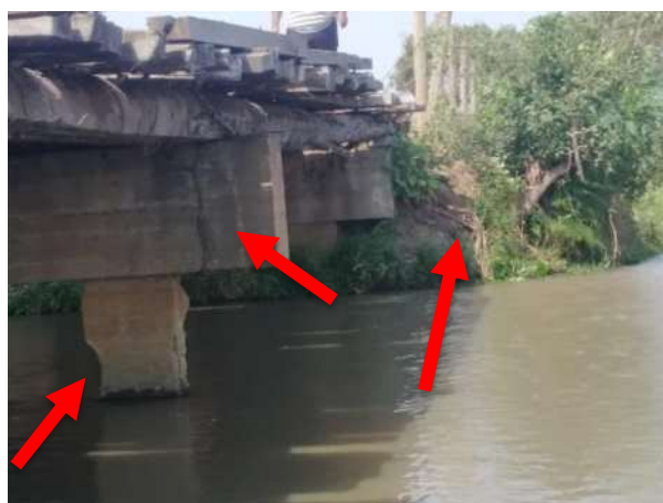
Figura 4 – Indício de ação de cupins/formigas/marimbondo nas peças de madeira, seção descontínua do pilar, escorregamento do talude.
