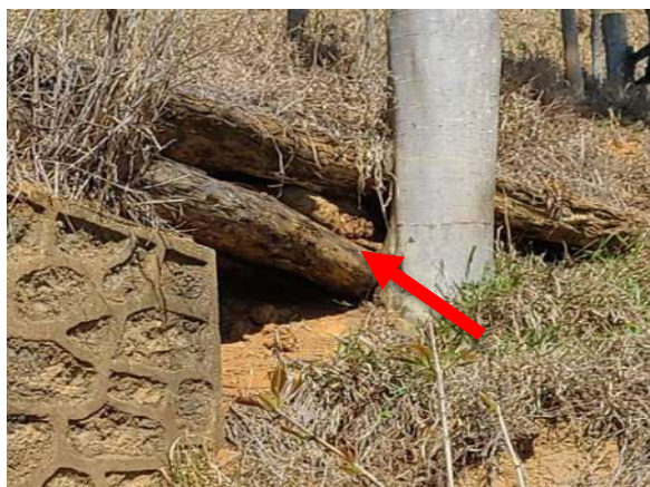
Figura 82 – Madeiras sofrendo degradação do tempo sem manutenção ou tratamento.
