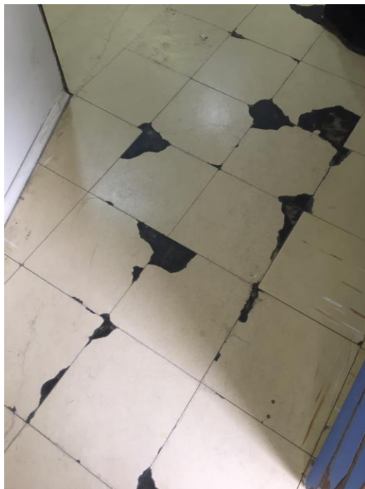
Figura 1 - Desgaste do Piso
