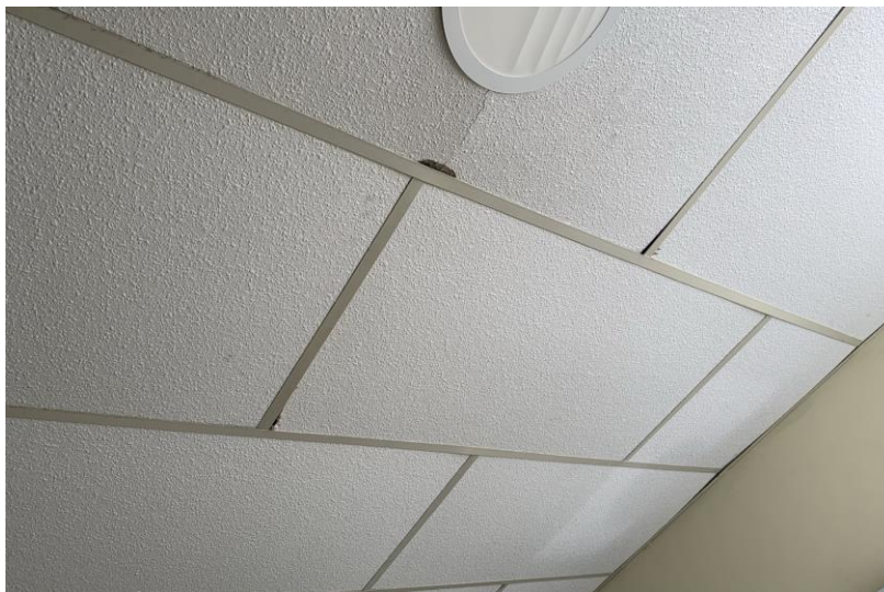
Figura 5 - Forro com defeito
