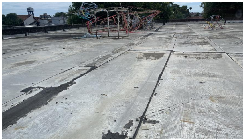
Figura 6 - Impermeabilização desgastada pela ação do tempo
