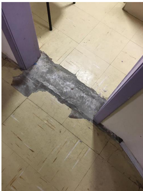
Figura 4 - Falta de Soleira
