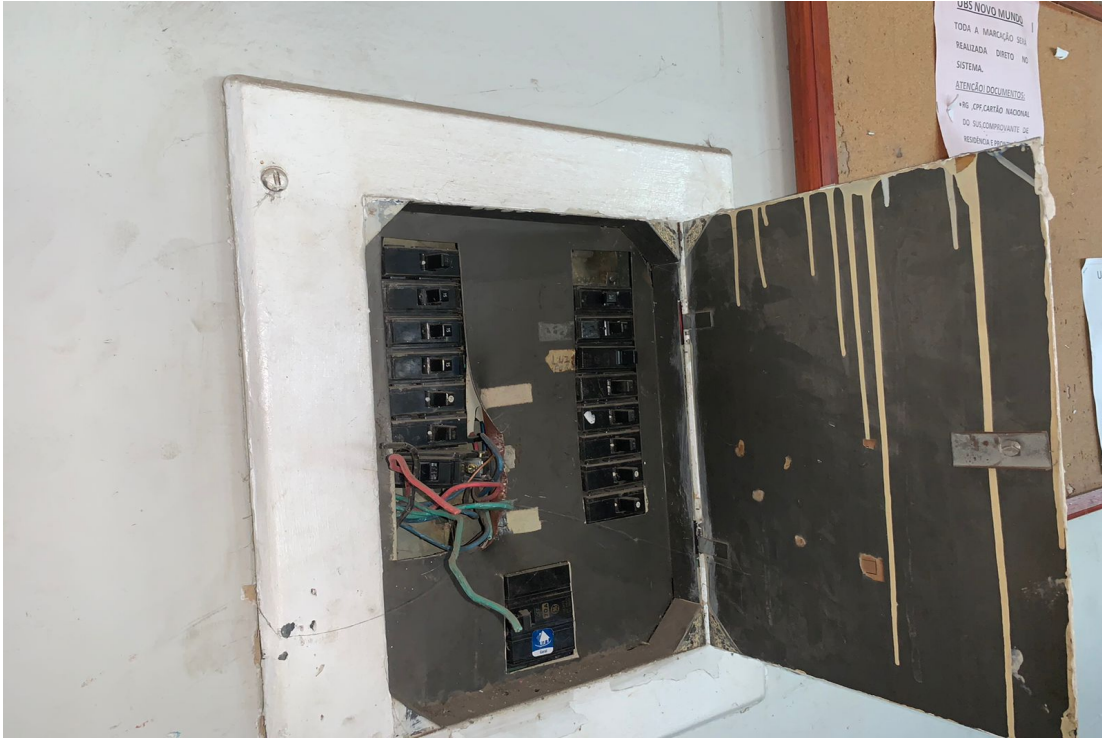
Foto 15: Quadro de distribuição
