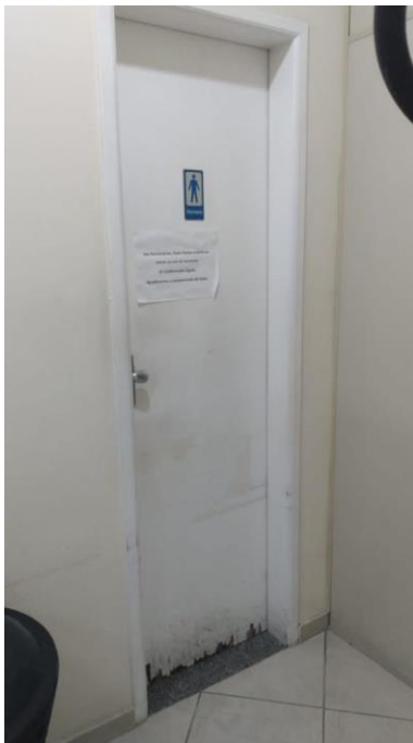
FOTO 17: Porta danificada sanitário masculino
