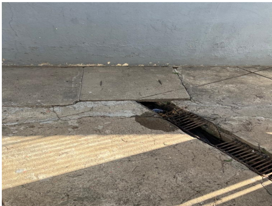
FOTO 8: Caixa e grelha – drenagem (fundos)
